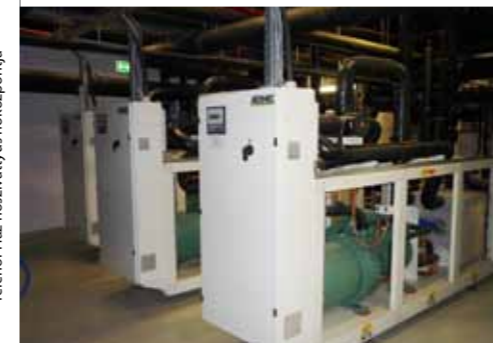
Telenor Ház hőszivattyús hőközpontja
