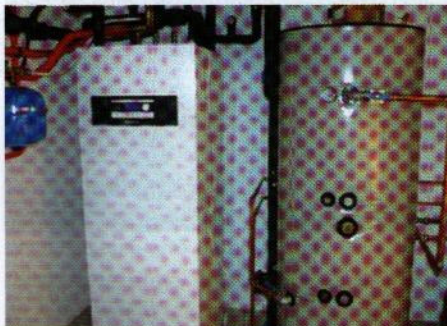
Családi házas hőszivattyús hőközpont
